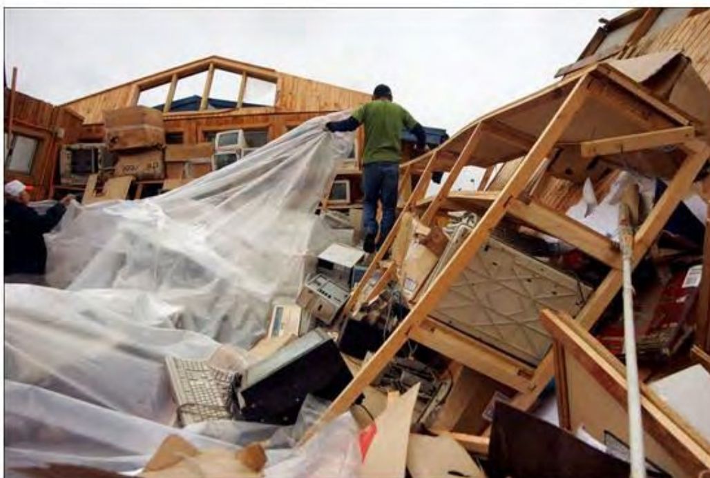
Foto 2: Producto de la intensidad del viento algunas construcciones livianas colapsaron. Foto adaptada de medios de prensa locales.
