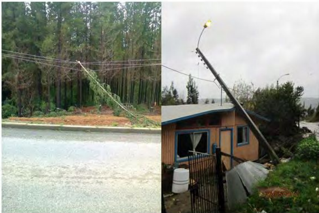
Foto 1: Al momento del Temporal, la vegetación aun presentaba abundante follaje, y por lo tanto mayor resistencia al viento, que le impidió soportar adecuadamente los intensos vientos, generando gran cantidad de arboles caídos y ramas rotas sobre el tendido eléctrico.
