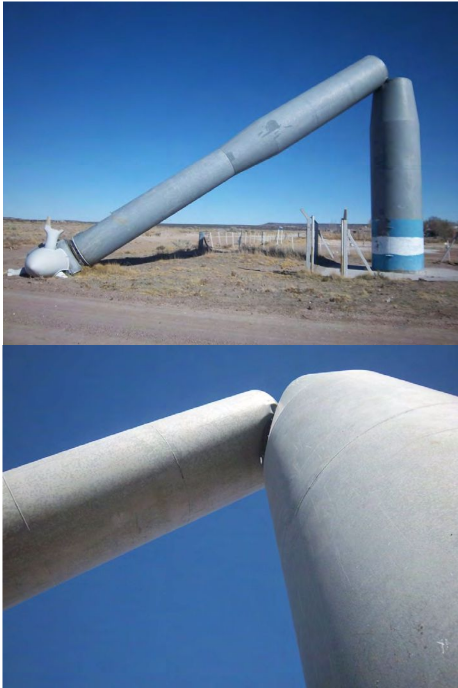
Figura 10: Torre colapsada en El Cuy, provincia de Río Negro (Saldía, 2011)
