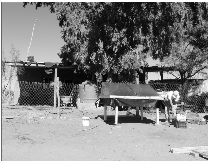
Fig. N° 1: Instalación de un destilador solar en un puesto de Lavalle
