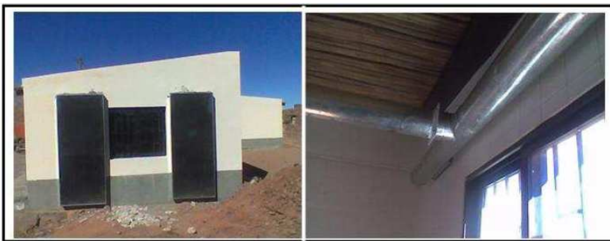
Figura 6: colectores colocados en la pared norte – oeste – norte, y una vista de los caños que distribuyen el aire caliente en el interior del local.
