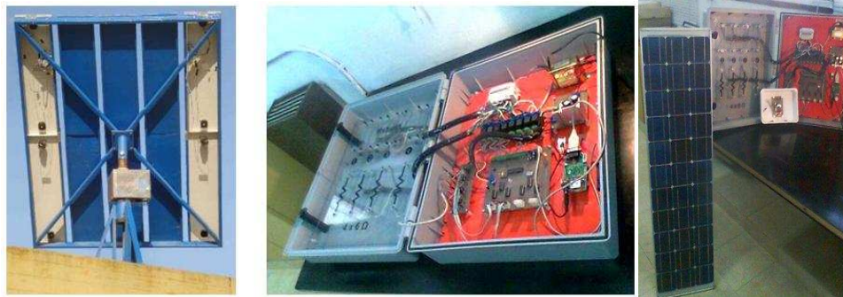
Figura 9: MSFVs montados sobre seguidor azimutal, gabinete principal. MSFV, gabinete principal y placas de estación meteorológica.
