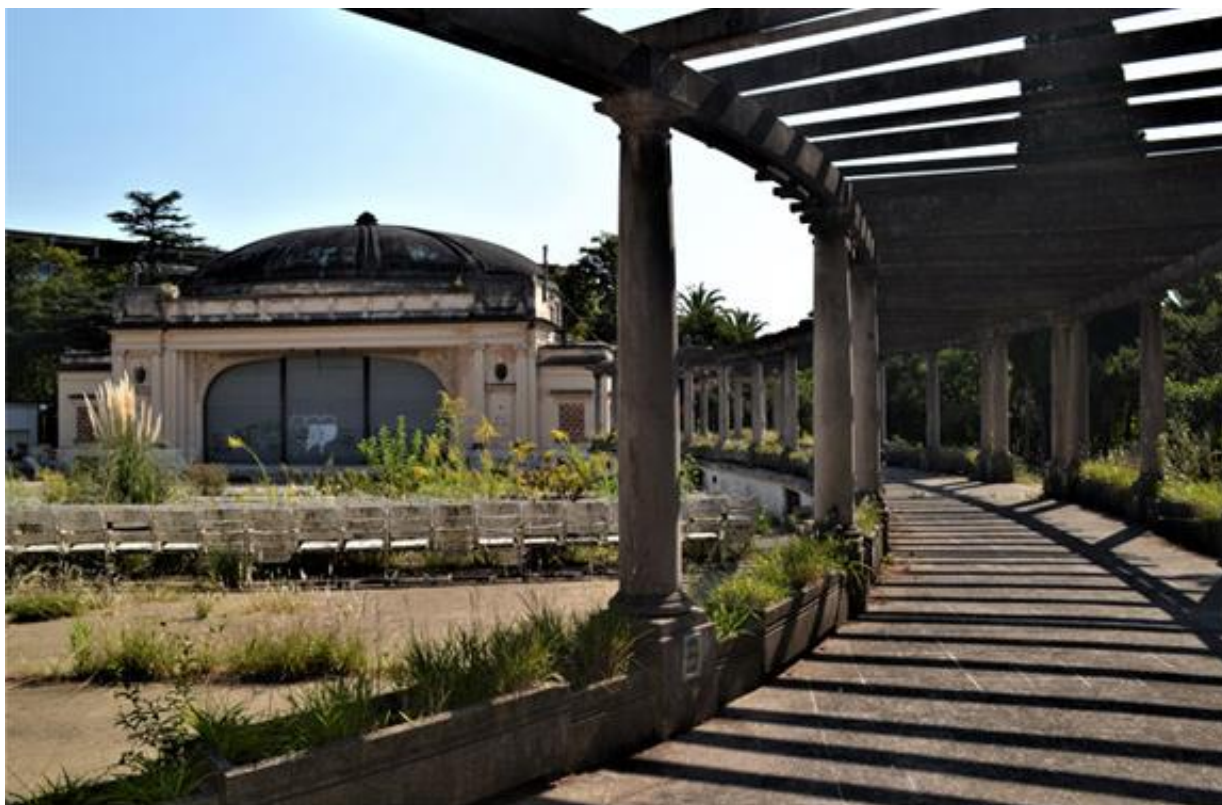
Fig. 8. Deterioro de la pérgola perimetral, grafitis en el edificio que contiene el escenario. 13 de marzo de 2020. Fuente: Autoría propia.
