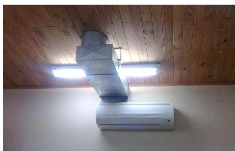
Figura 5: Adaptación del sistema desecante- evaporador.
