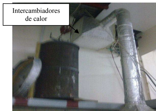
Figura 3: Silica gel e intercambiadores de calor.
