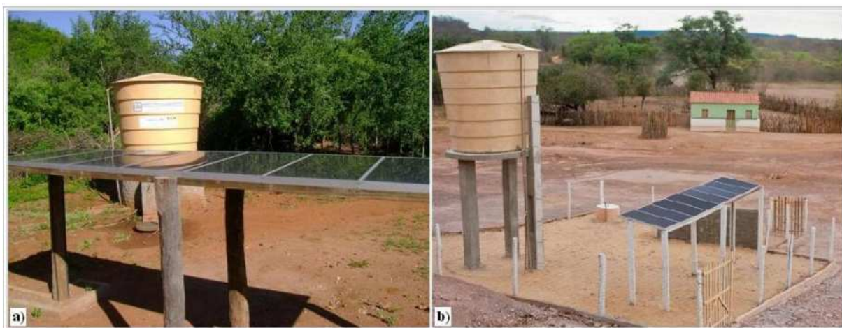
Figura 5. Generador fotovoltaico y depósito del sistema de bombeo de agua en las comunidades de Piauí: a) Garrincha (São Raimundo Nonato) y b) Capim (Guaribas). (Fonte: Moraes, 2009)
