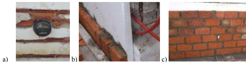
Figura 2: Detalles de a) la chimenea de la calefacción a gas, b) la aislación y la entrada de los tubos(sobre una pared lateral) y c) pared protectora de ladrillo de canto.
