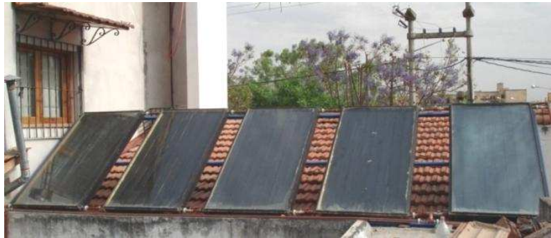
Figura 4: Vista del sistema de Colectores ubicados en el techo.
