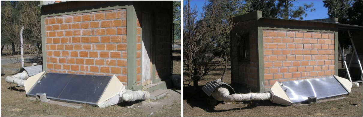
Figura 5 y 6: Fotografías del colector poroso adosado al sistema de calentamiento por piso radiante.
