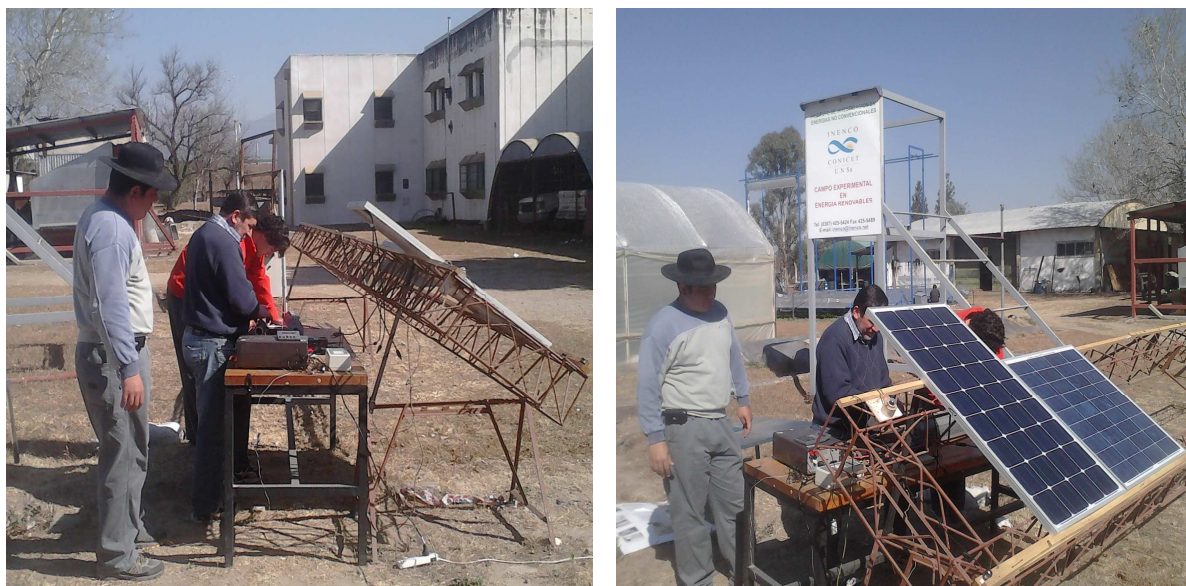
Figura 5: imágenes fotográficas de la estructura soporte de módulos fotovoltaicos y medición de radiación
