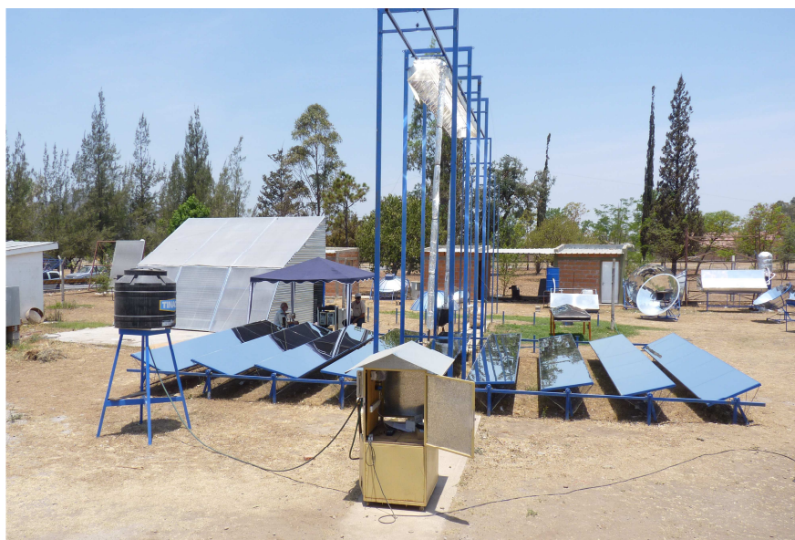
Figura 2: Foto del concentrador Fresnel lineal de 43 m 2
