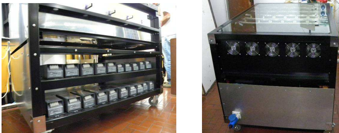
Figura 5: a) Vista lateral de las reactancias, b) Extractores de aire de refrigeración.
