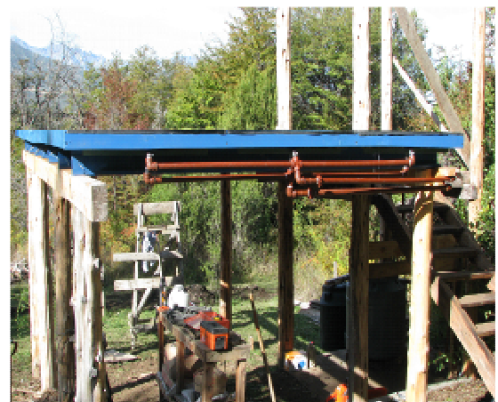
Figura 11. Detalle de los colectores de agua.
