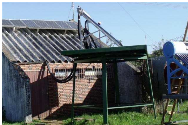
Figura 5: Coletor solar de tubos evacuados montado na bancada
