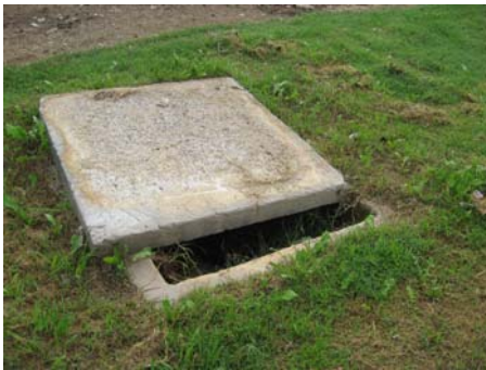
Foto 38: Cámara de sedimentación
