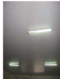
Foto 36: Iluminación del galpón principal
