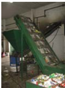
Foto 30: Cinta transportadora de tres módulos
