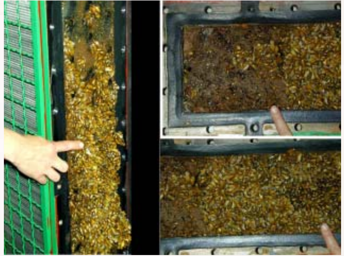
Figura 8: «Macrofouling» en la tapa e interior de un intercambiador de calor de una central hidroeléctrica. Fotos: Gustavo Darrigran.
