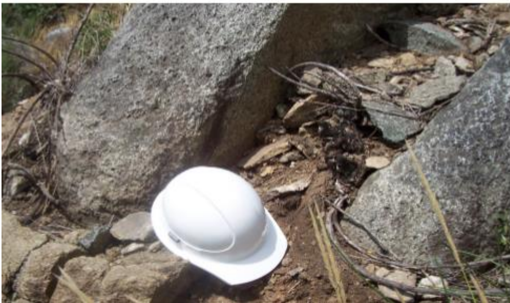
Figura 15.- Detalle de meteorización diferencial en el margen derecho de la presa Ramal H. Se observan bloques de material rocoso levemente alterados, limitados por discontinuidades subverticales y entre estos, un bloque altamente cizallado, meteorizado y en gran parte erosionado. Tomado de Giaconi (2009).
