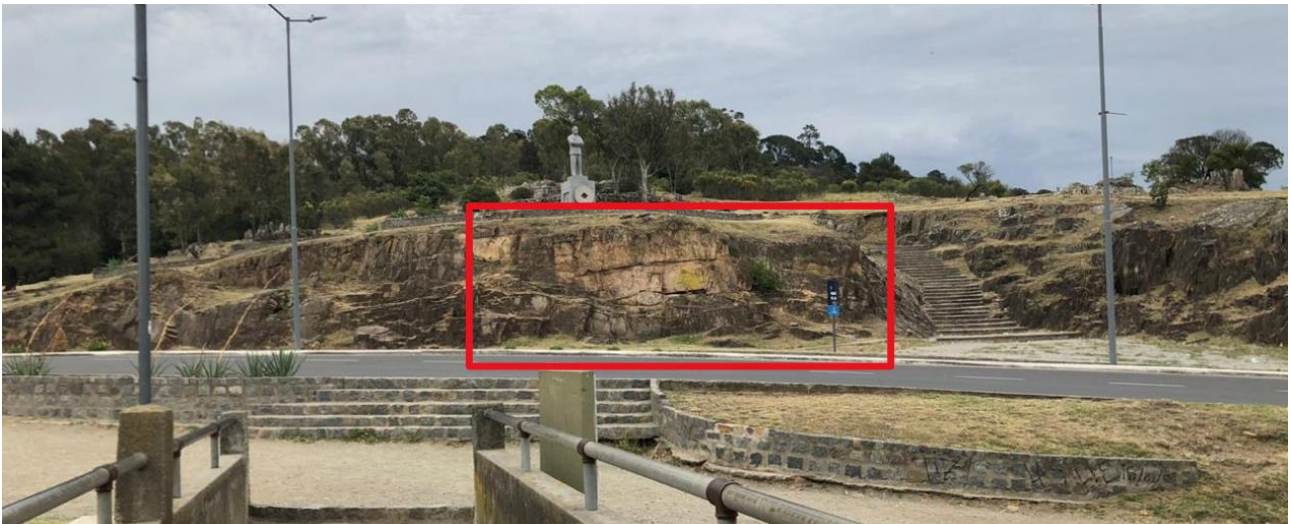
Figura 22.- Parte del afloramiento del margen derecho del Dique del fuerte visto desde arriba del mismo, en rojo se visualiza el sector donde se llevó a cabo la caracterización
