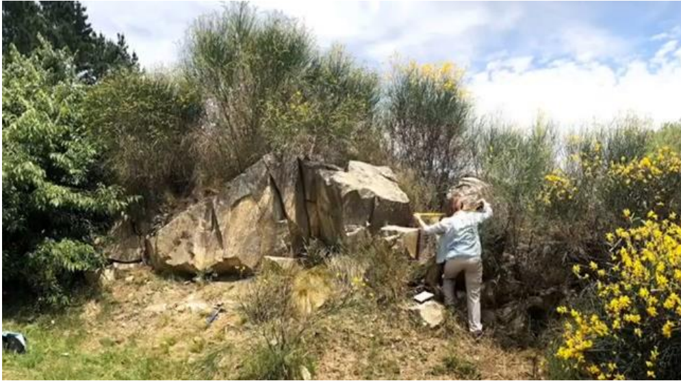
Figura 14.- Afloramiento identificado en el estribo derecho de la presa Ramal H. Se observa decoloración en la superficie de los bloques y de las discontinuidades, con presencia de lajosidad.
