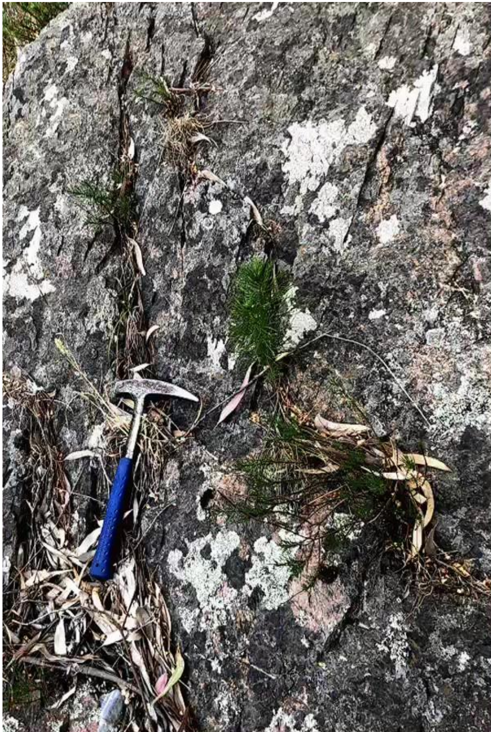
Figura 29.- Detalle del macizo rocoso de la margen derecha de la presa. Se observan diaclasas en varias direcciones, muchas de ellas enmascaradas por la vegetación. En el sector superior derecho se reconocen diaclasas poco espaciadas correspondientes al set 3. Se visualiza también la patinas de líquenes y la meteorización catafilar.
