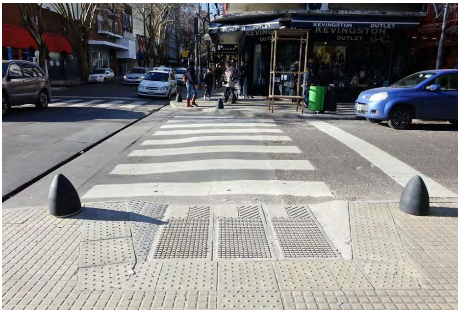
Figura 57: Colocación de rampas sin continuidad con la senda peatonal. Fuente: Archivo propio, 2018.
