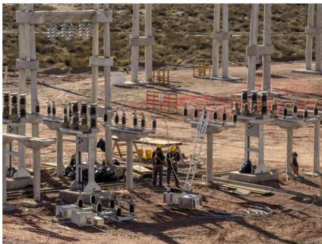
Figura 148. Estación Transformadora Loma Campana, Añelo Fuente: Gobierno de la Provincia de Neuquén, 2016 B.
