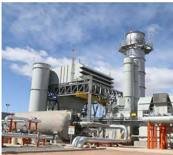
Figura 147. Central Loma Campana I, Añelo Fuente: YPF Luz, 2019.
