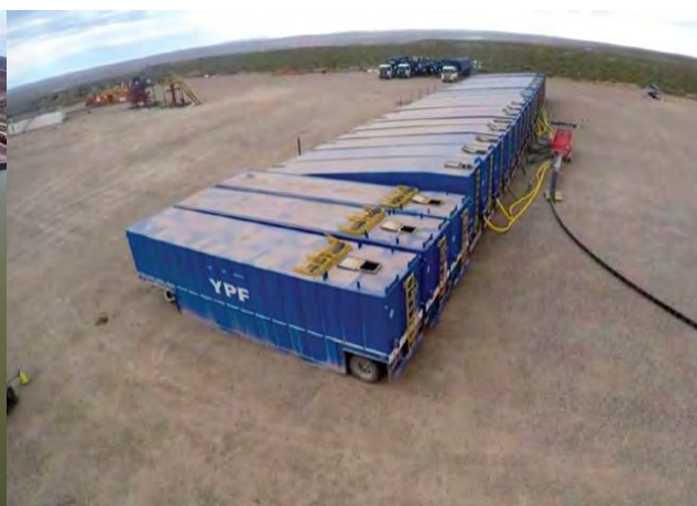
Figura 36. Sistema de bombeo, área Loma Campana, YPF. Fuente: Sitio web YPF.
