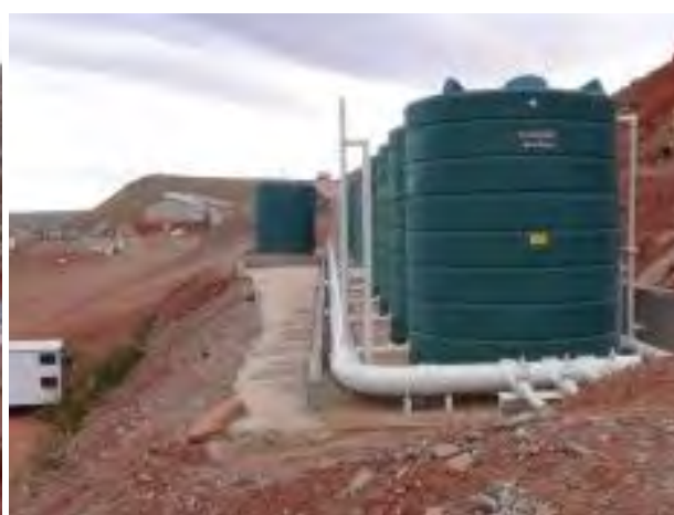
Figura 145. Tanques de almacenamiento de agua potable, Añelo. Fuente: Municipalidad de Añelo, 2015 A
