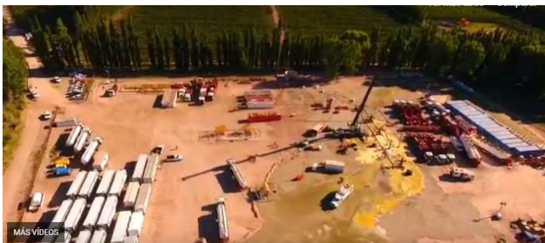
Figura 85. Derrame de fluidos de perforación en Estación Fernández Oro, Río Negro, 2018. Fuente: ADN Río Negro, 2018.
