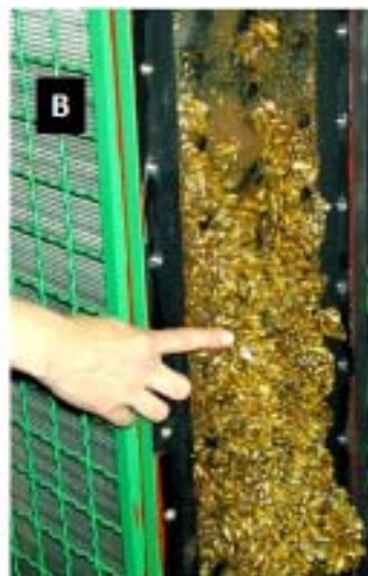
Figura 6: Ejemplares de Limnoperna fortunei , ocasionando «macrofouling» en: A Tomas de agua en plantas potabilizadoras de agua («parshall»), B Intercambiador de calor de una central hidroeléctrica. (imagen tomada por G. Darrigran).
