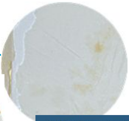
Dobles y desprendimientos
