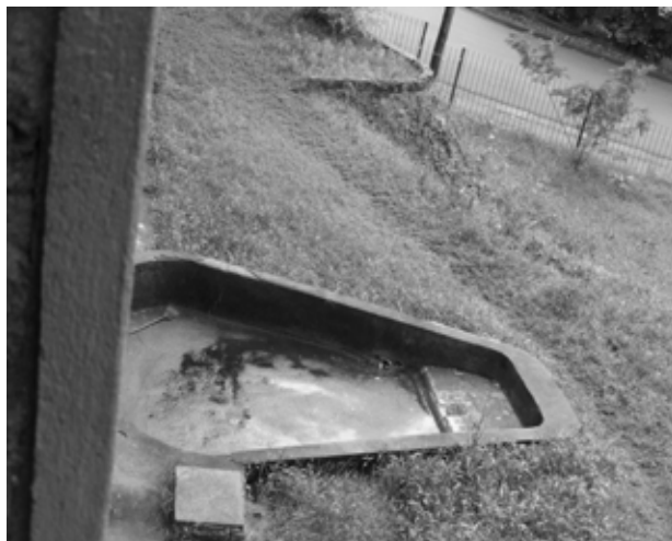
Detalles de la cisterna y receptáculo para desagüe pluvial de la escuela en Alem
