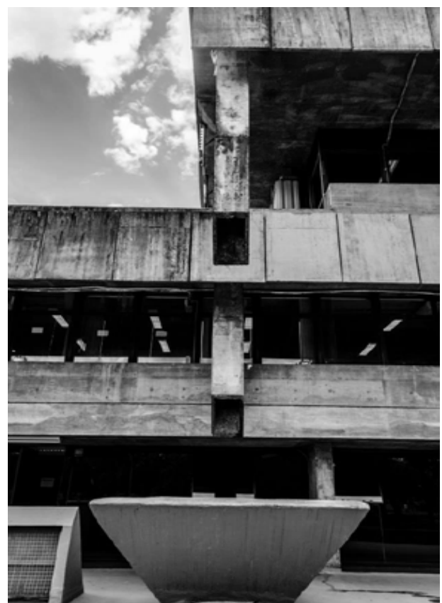
Detalles de la canaleta del Palacio de Justicia en Brasilia, obra de O. Niemeyer; detalle receptáculo tipo bache del edificio del ectorado de la Universidad de Brasilia.
