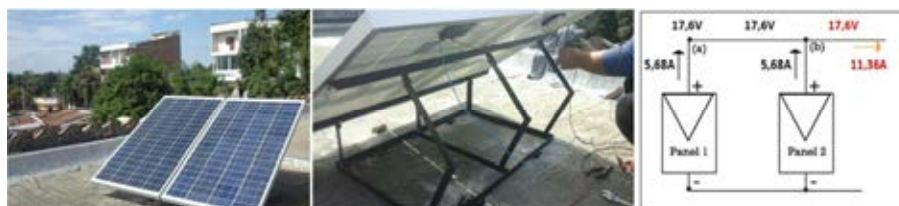
Figura 4: Paneles instalados en la terraza, conectados en paralelo.
