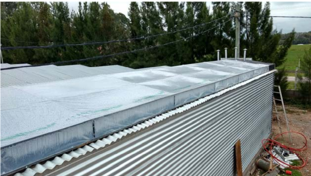
Figura 4: Sistema de colector solar en el techo de la estufa mejorada. Cubre el sistema de recuperación de calor.
