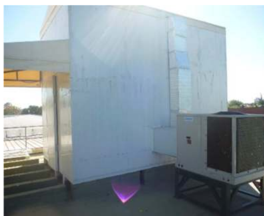
Figura 4: Vista General del Equipo HVAC
