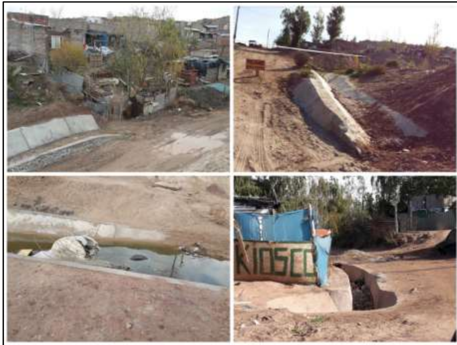
Figura 14: Estado de las obras pluvioaluvionales
