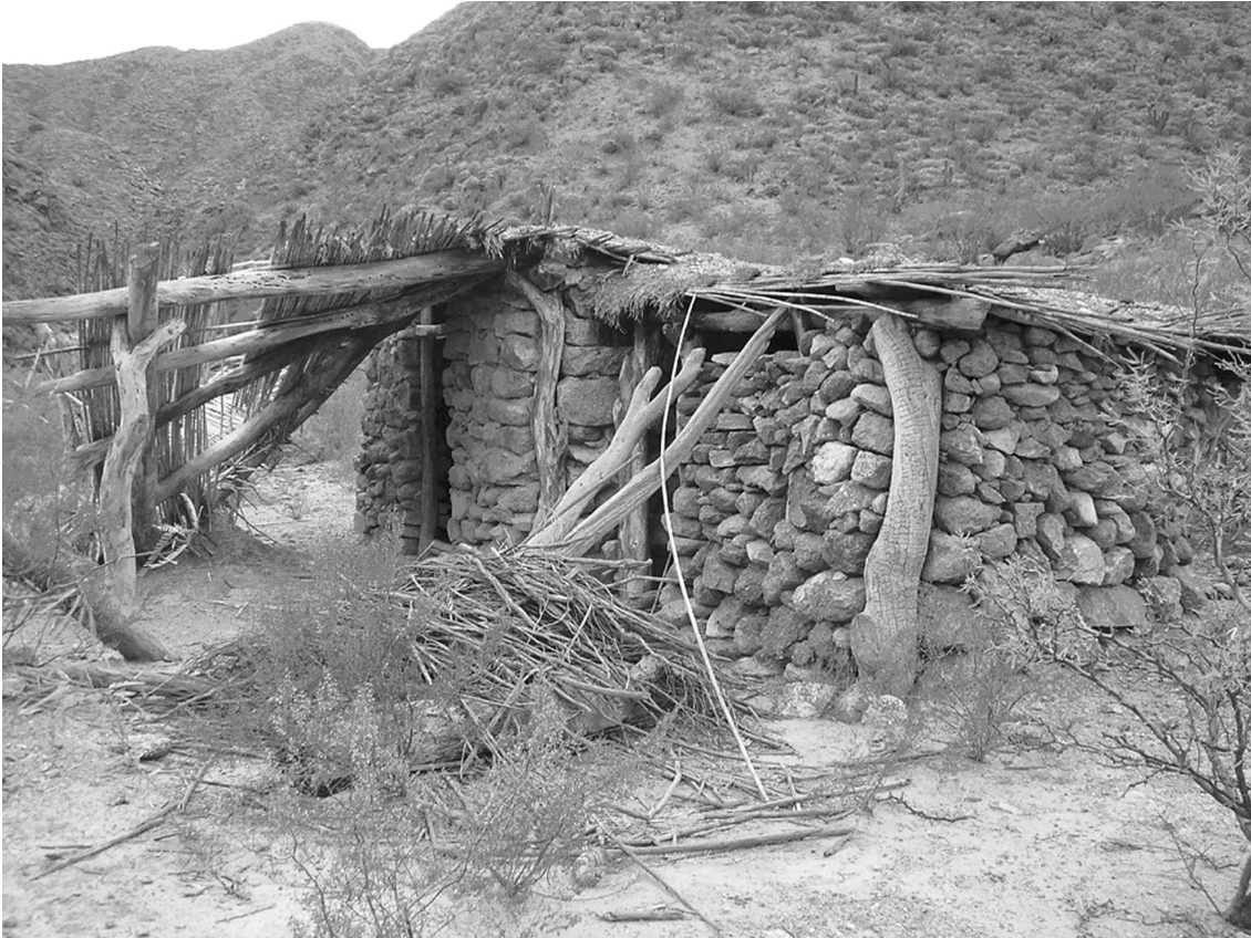
Fig. 7. Derrumbe diferencial de techo en vivienda actual (Valle de Hualfin).
