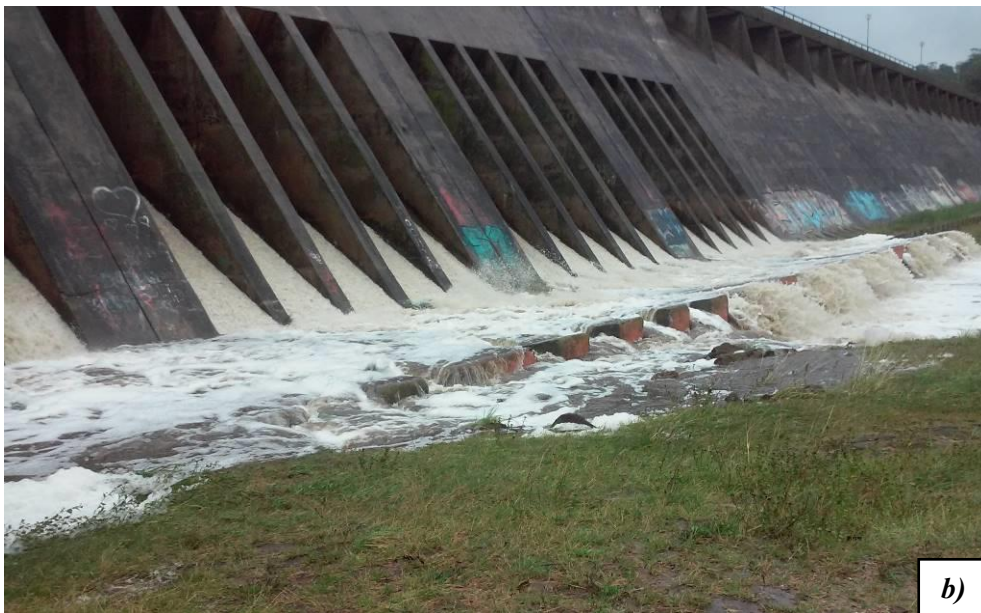
Figura 65. Sitio 4: Salida del embalse. Ante momentos de estiaje (a) y crecida (b)
