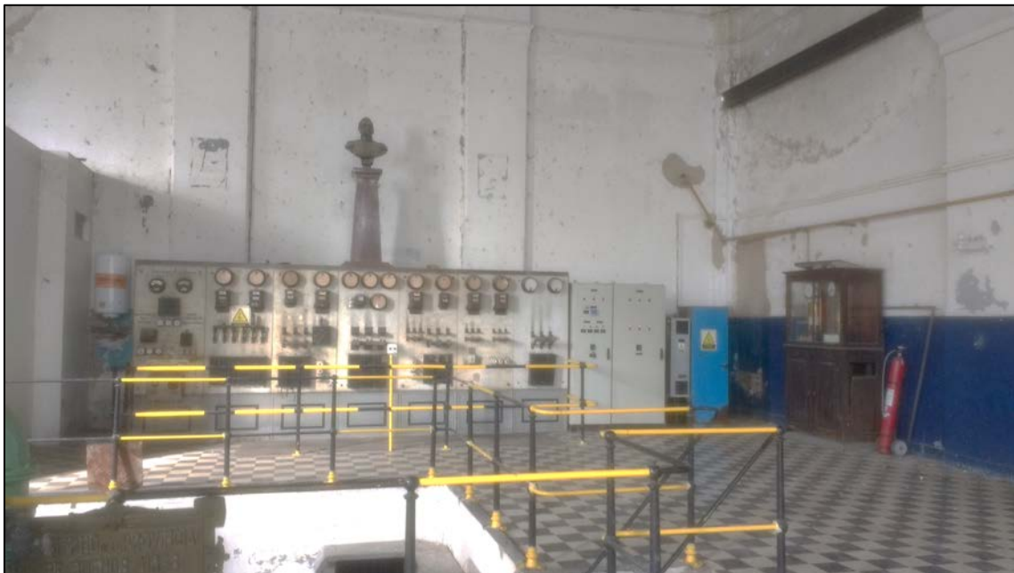
Figura N° 8. Fotografía de la sala de máquinas de la Usina del Parque San Martín.
