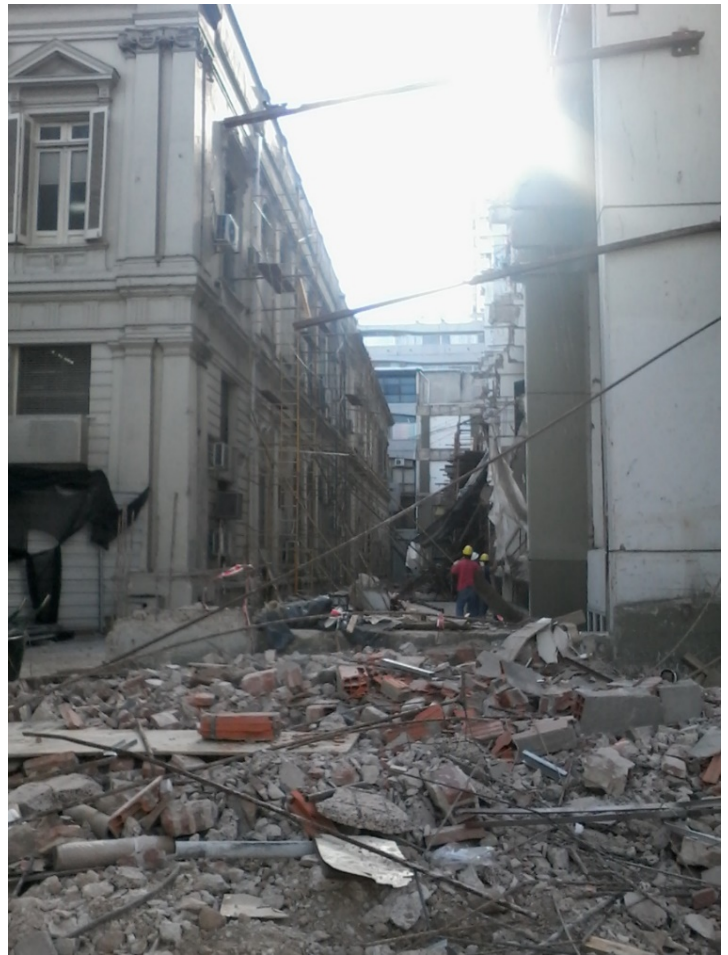
EDIFICIO "SERGIO KARAKACHOFF" / OBRAS DE DEMOLICIÓN Antes y después, sector de contacto con Edificio Presidencia
