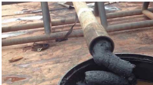
Fig. 3. Taponamiento en cañería.
