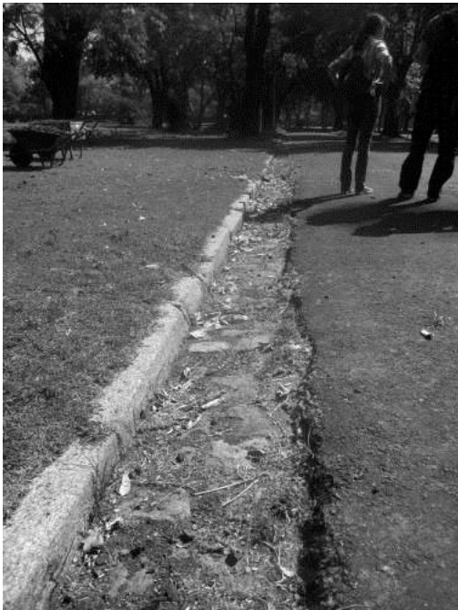
Figura 8. Debajo del asfalto actual aún se aprecia el adoquinado original de una de sus calles internas.
