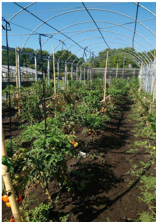
Figura 1.4: Cubierta N°1 de la Estación Experimental de Gorina sin plásticos después de la tormenta del 5 de febrero 2017.
