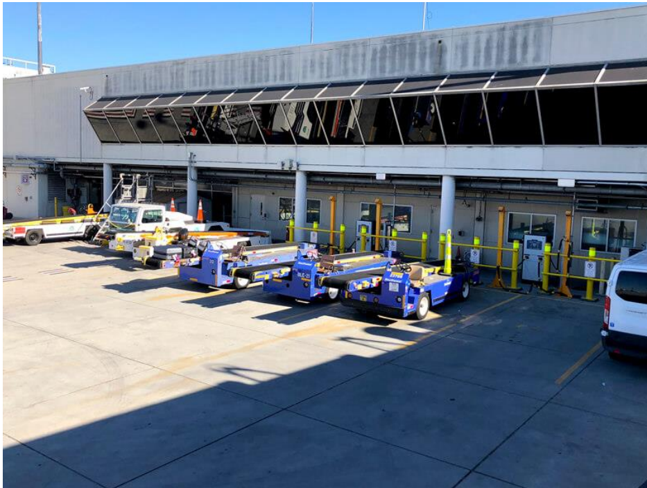
Figura 29 - Estaciones de carga Aeropuerto Internacional de Oakland
