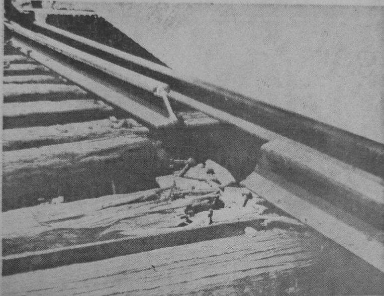
El artefacto explosivo arrancó un tramo del riel y durmientes, originando la interrupción del servicio ferroviario en el puente del arroyo Carnaval en City Bell.
