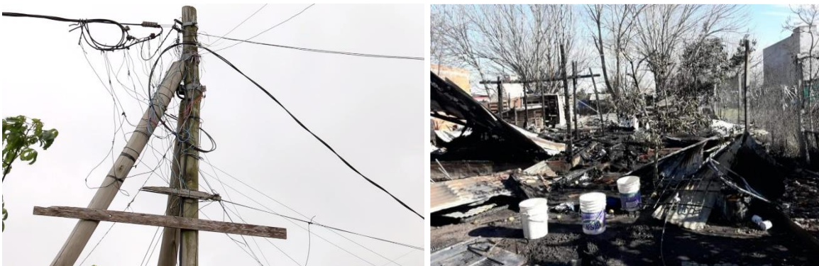
Fotos 23 y 24. A la izquierda, conexiones de cables en un poste de luz. A la derecha, los restos de una casa destruida por un incendio generado por la conexión eléctrica precaria (Foto izquierda, Tomás Canevari; derecha, anónima)
