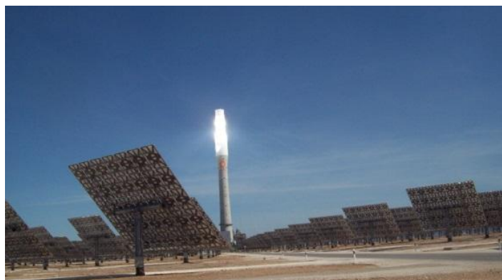
Figura 2. Torre solar Gemasolar, Sevilla 20MW.
