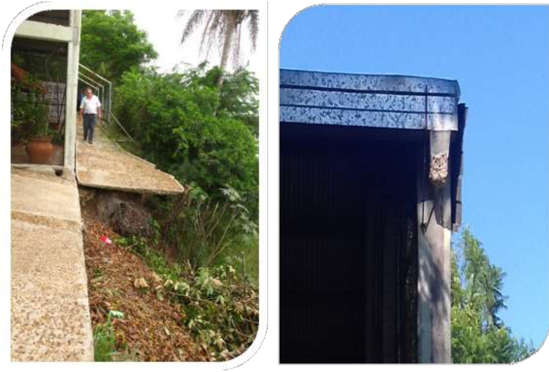
FOTOS 37 Y 38: CASA DEL FUNDADOR, DESMORONAMIENTO Y PLUVIAL ANULADO POR SER GENERADOR DE LA EROSIÓN (FOTOS PROPIAS).
