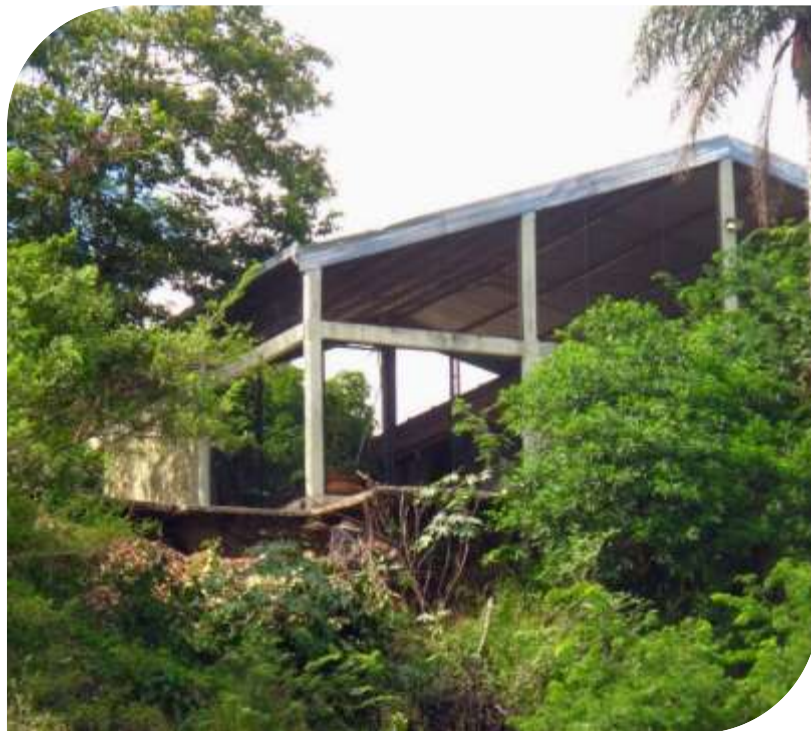
FOTO 36: CASA DEL FUNDADOR, DESMORONAMIENTO Y PLUVIAL ANULADO POR PRODUCIR LA EROSIÓN (FOTO PROPIA).
