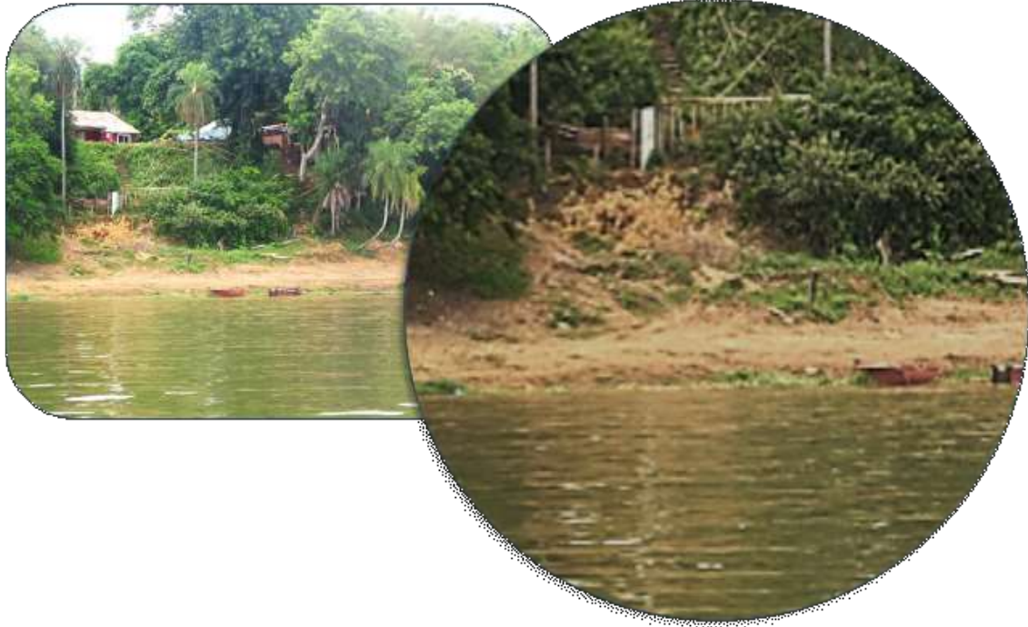
FOTO 24: BAJADA Y LIMPIEZA DE LA VEGETACIÓN EN UNA CASA SOBRE LA COSTA; FOTO 25: DETALLE DE LA EROSIÓN ASOCIADA A SUELO DESNUDO, TRÁNSITO Y LAVADO DE SUELO. (FOTOS PROPIAS).
