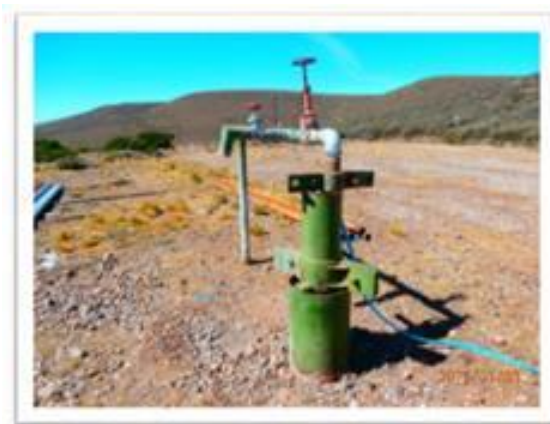
Figura 8: toma de agua de acuífero en el Barrio Caleta Córdova.
