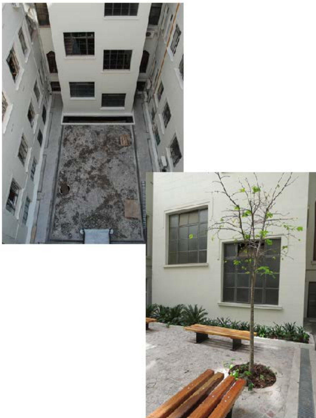
Fig. N° 57 y N° 58.- Imágenes de la intervención edilicia en el patio interno del Edificio de Paseo Colón N° 922, durante la ejecución de los trabajos y resultado final. (Autoría: arquitecto Marcelo Magadán- Año 2013).
