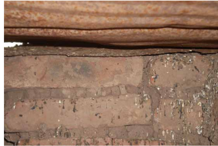
Figura 2. Rastro de deyecciones de vinchucas en las paredes. Ne'enaqtac 2. Chiincha la'atec ishipaxanaqchet ca hueque.
