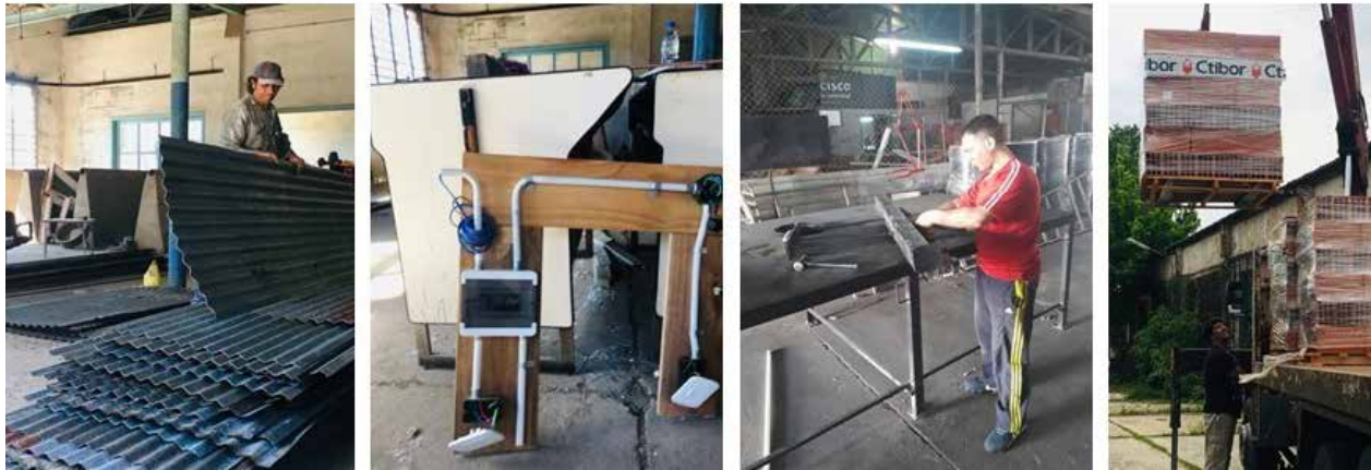
Donación N° 1: chapas y tablero eléctrico
