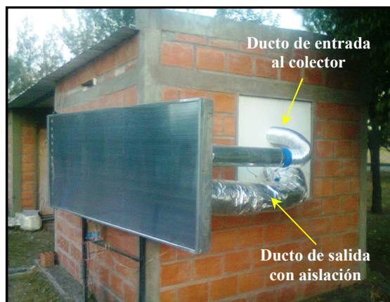
Figura 3: Colector solar conectado al prototipo de edificio.
