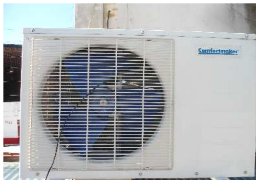
Figura 2: Foto del condensador y termocupla tipo K
