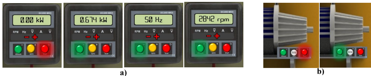
Figura 3.- Elementos de control. a) Tablero de control de la bomba centrífuga. Se puede observar la secuencia: bomba apagada – bomba encendida con la posibilidad de alternar el display entre: potencia, frecuencia y velocidad de giro del motor. b) Tablero de control de la bomba de vacío (apagado - encendido)
