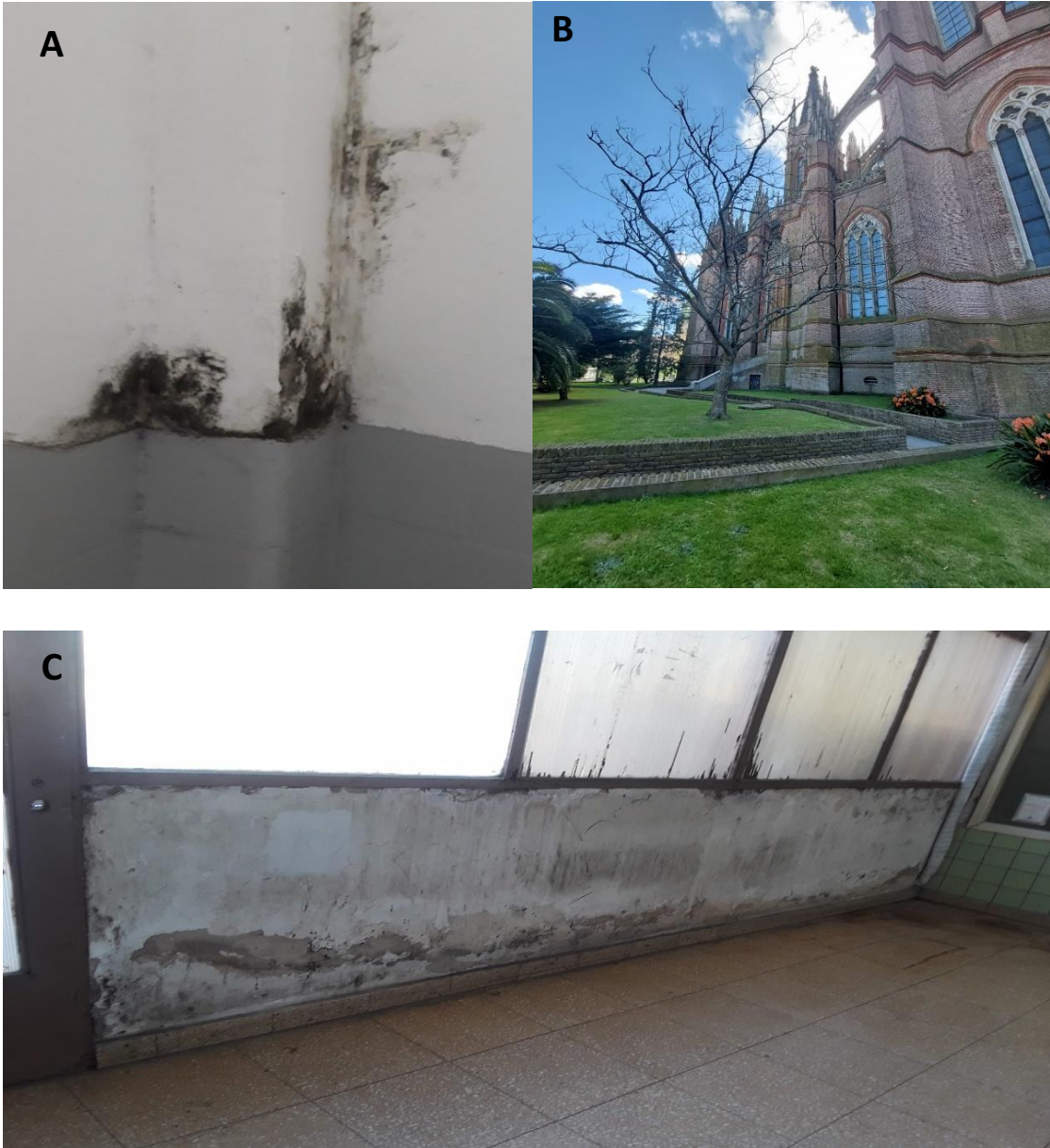
Figura 1.5. Deterioro de materiales estructurales debido a la actividad del biofilm fúngico. A y C: Paredes de interiores en construcciones edilicias. B: Fachada de la Catedral de La Plata
