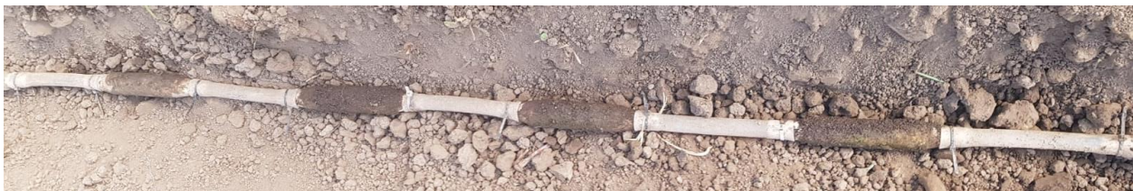
Figura 3. Módulo lineal instalado a campo.
