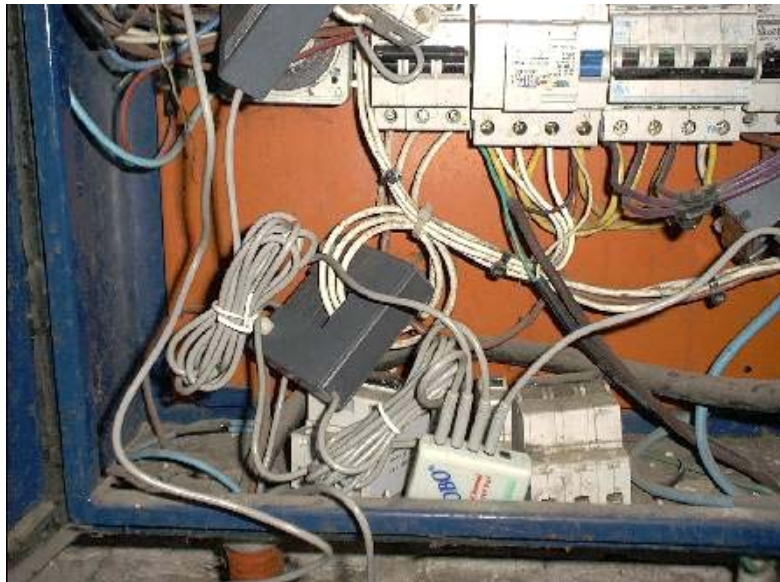
Figura 6-25: Sensores AC en tablero eléctrico
