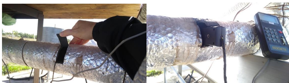
Figura 5 a. Apertura en el ducto de recirculación para ingreso del anemómetro b. Toma de registros de velocidad del aire en el ducto de recirculación
