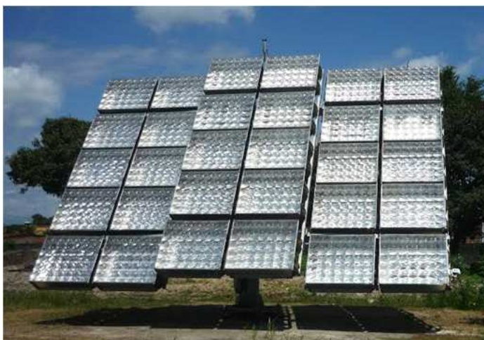
Figura 1. Gerador HCPV instalado no Departamento de Energia Nuclear-UFPE.
